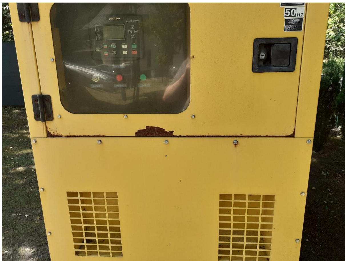
Zdjęcia uszkodzeń obudowy generatora GAPPA 120
